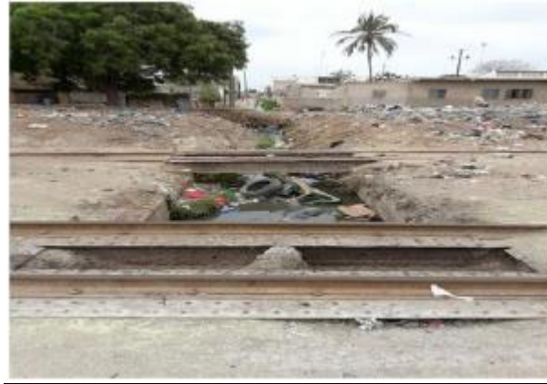
Photo 24 : Réseau ONAS empiétant sur les rails à Rufisque
